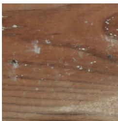
Surface mould/Moho superficial/ Moisissures superficielles/ Oberflächlicher Moder/Muf fa su- perficiale/Oppervlakte-schimmel/ Bolor superficial
