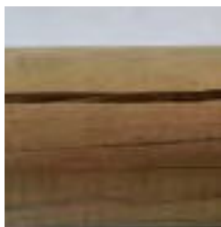
Cracks/Grietas/Fente/Risse/ Crepe/ Barsten/Fendas
