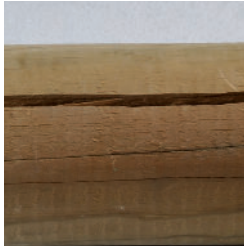
Cracks/Grietas/Fente/Risse/ Crepe/ Barsten/Fendas
