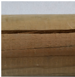
Cracks/Grietas/Fente/Risse/ Crepe/ Barsten/Fendas
