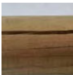
Cracks/Grietas/Fente/Risse/ Crepe/ Barsten/Fendas
