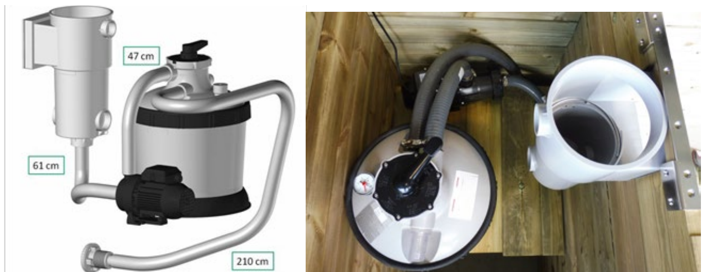
Figura 25 – Conexión del sistema de filtración Filtro / Bomba / Succión / Retorno
