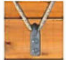
Abbildung der an der Oberfläche vorhandenen Haken
