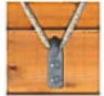
Abbildung der an der Oberfläche vorhandenen Haken
