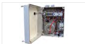
13 Cuadro eléctrico para motor cajón estanco
